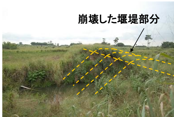
図 2.2.4 崩壊した堰堤
