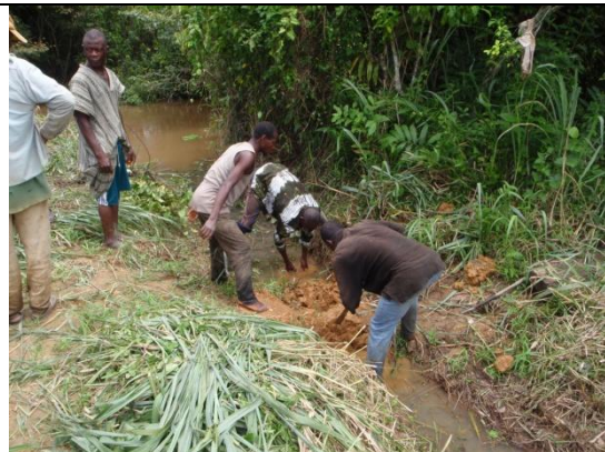
写真 4. 農民が造った簡易水路。水を引きたいときには、堰止め用の土を開削する。
