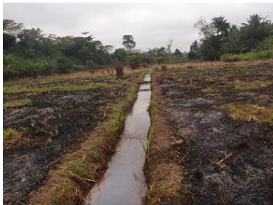
図 3.3.4 十分に機能していない排水路
